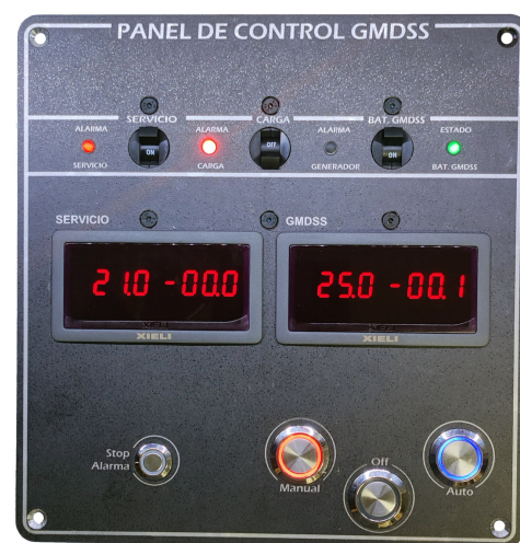
Pulsadores Rojo y Azul simultáneamente indican que el Panel a conmutado a modo Manual automáticamente
